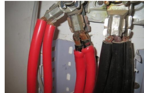
Risque de court-circuit
